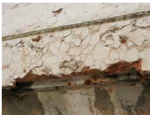
5-8. Degrado del paramento in Rosso di Verona. Dall'alto: fenomeni di compressione, elementi distaccati, fessurazioni, scagliature.
